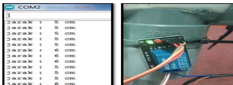
Gambar 3.8 Kondisi irigasi tersumbat
